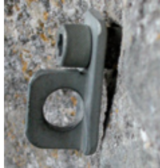
Eine Sanierung ist hier dringend nötig.
