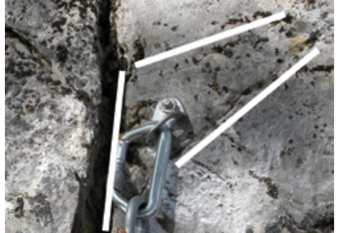
Zu geringer Abstand zum Riss
