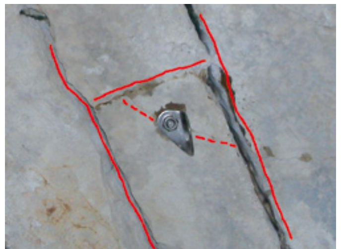
Zu geringe Abstände sowie Risse im Gestein
